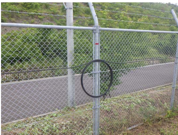
ネットフェンス 直線部 B
